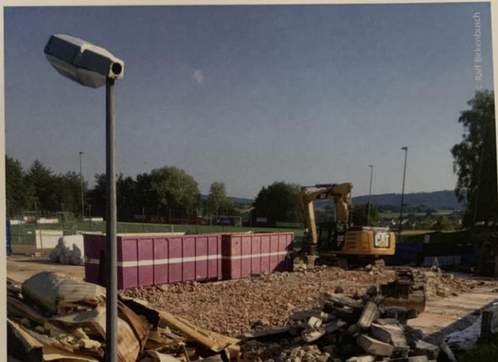
Das Vereinsheim des SV Unterweissach wurde durch einen Brand stark beschädigt: Im Moment laufen die Arbeiten für den Wiederaufbau auf Hochtouren.
